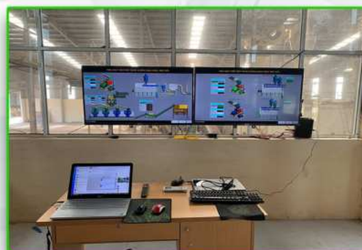
Quản lý nhà máy bằng Scada
