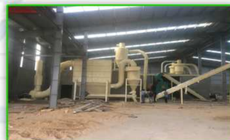
Hệ thống giữ bụi
