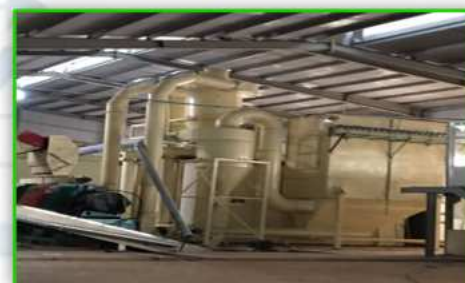
Hệ thống giữ bụi
