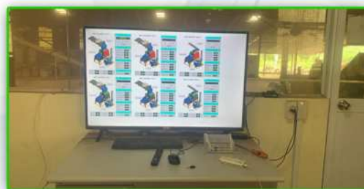
Quản lý nhà máy bằng Scada
