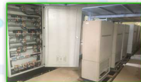
Hệ thống biến tần điều khiển
