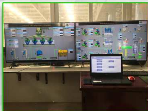
Quản lý nhà máy bằng Scada
