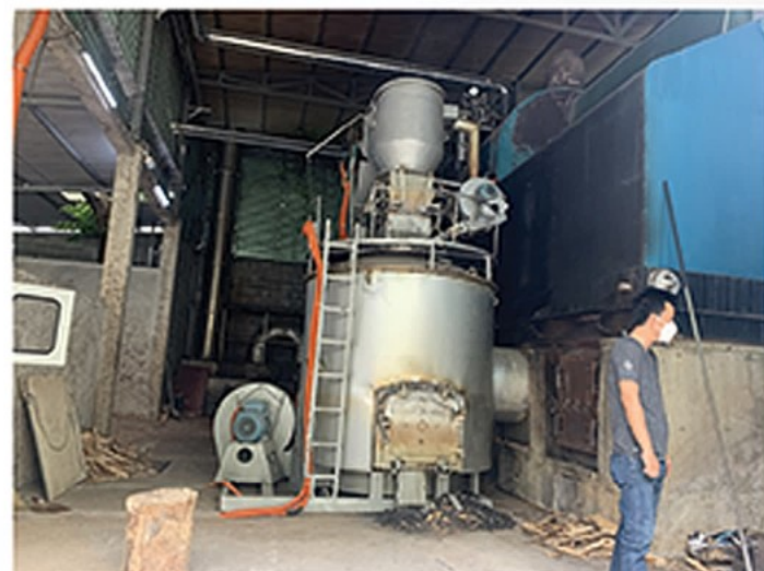
LÒ ĐỐT CHO LÒ HƠI 8 TẤN
