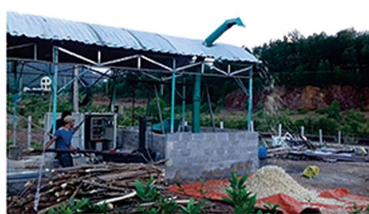
Máy băm gỗ lắp vào vị trí sản xuất
